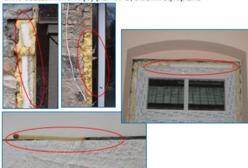
Rys. 5 (d, e, f, g, h, i). Przykładowe błędy montażu okien
