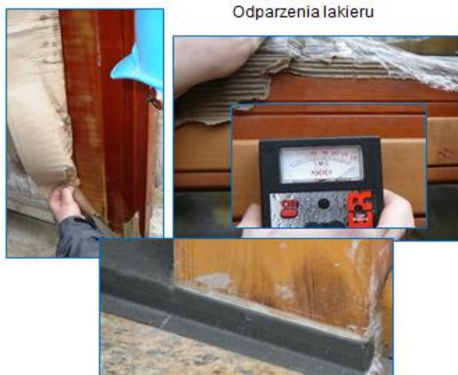
Rys. 5 (a, b, c). Przykładowe błędy przechowywania przed montażem
